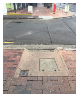
Non DDA kerb ramps
